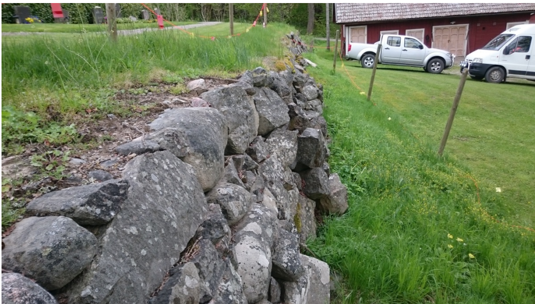
Muren har glidit ut. Foto Markmästarna.
