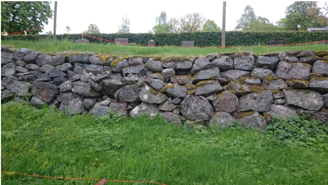
Det skadade murpartiet. Foto Markmästarna.
