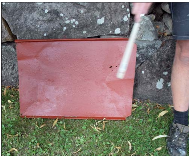
Lucka i lanternintaket med rosthål. En ny lucka tillverkades och den gamla ställdes i ett tornrum. Foto Östergötlands museum 2013.
