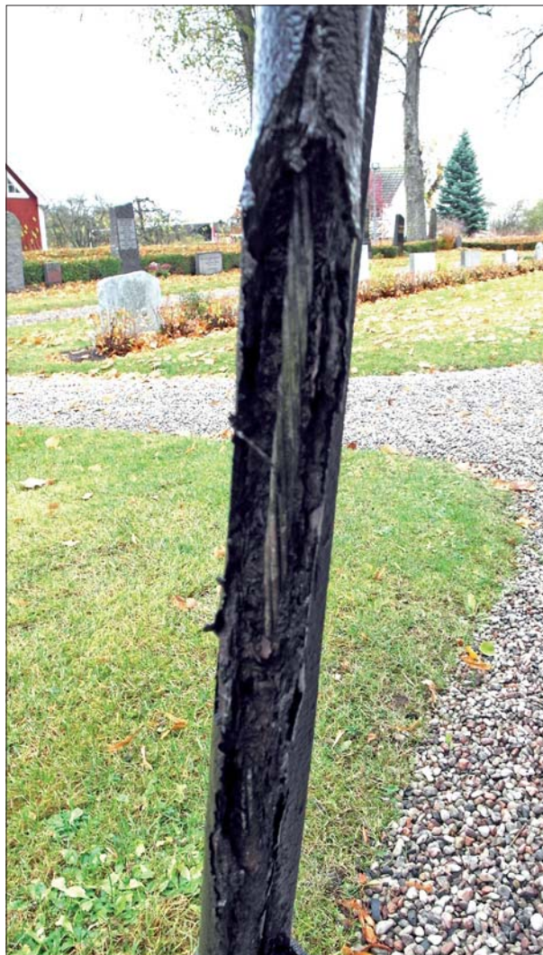
Skada på järnspjut till åskledaren. Foto Östergötlands museum 2013.
